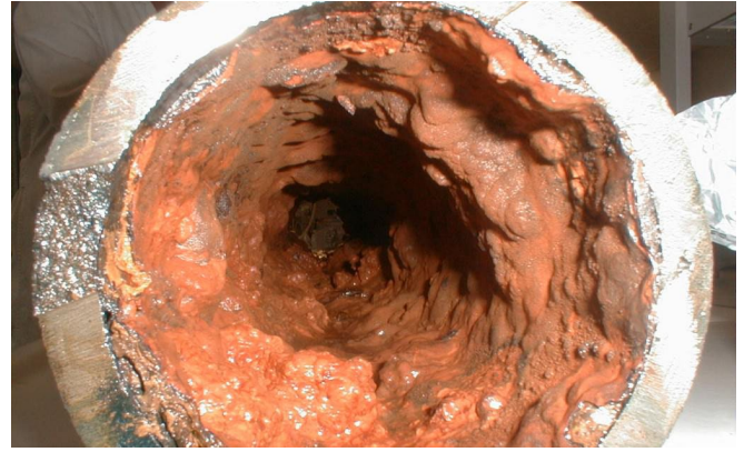
ΕΙΚΟΝΑ 1: Βιοφίλμ και εναποθέσεις στον υδραγωγό.
